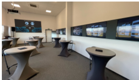
WWVT ACADEMY - OG • SCHULUNGSRAUM • KONFERENZTECHNIK • SIGNAGE UND STREAMING SCREENS
